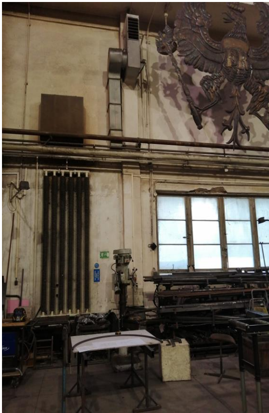
Obr. Vykurovací register a nefunkčný ohrievač vzduchu
