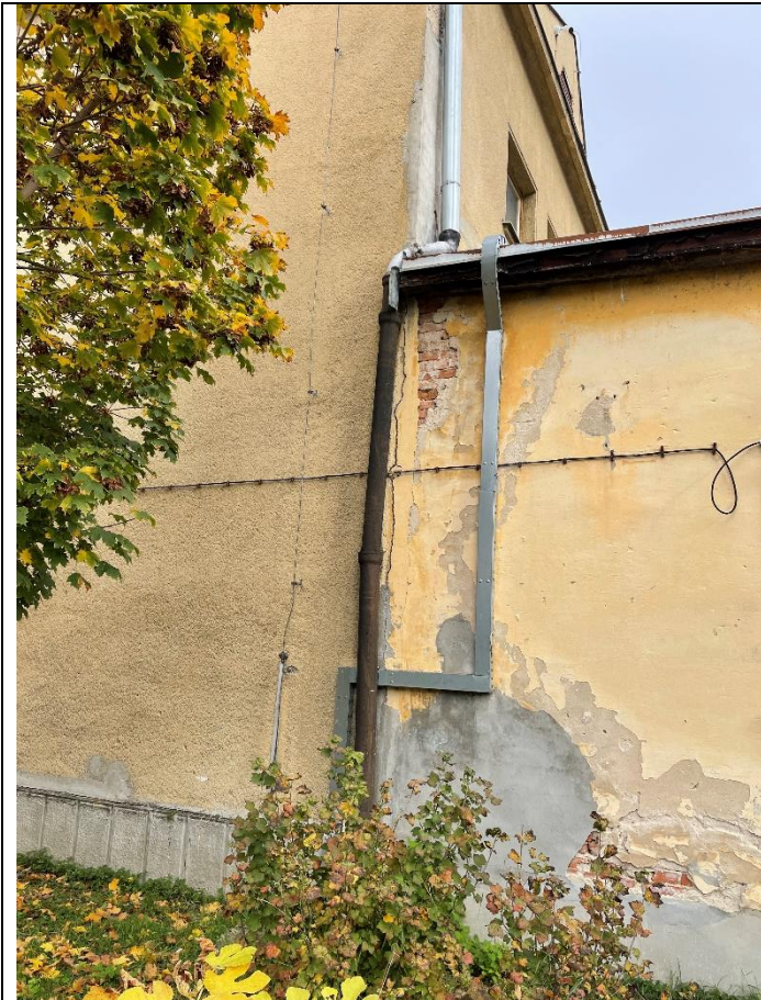
Opadaná omietka vplyvom pôsobenia zrážkovej vody z poškodeného dažďového zvodu
