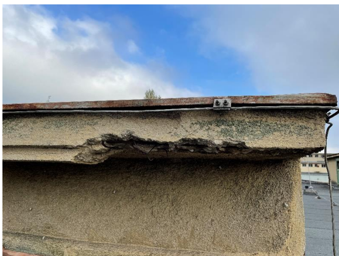
Odhalená výstuž rímsy atiky na streche nad 3.NP
