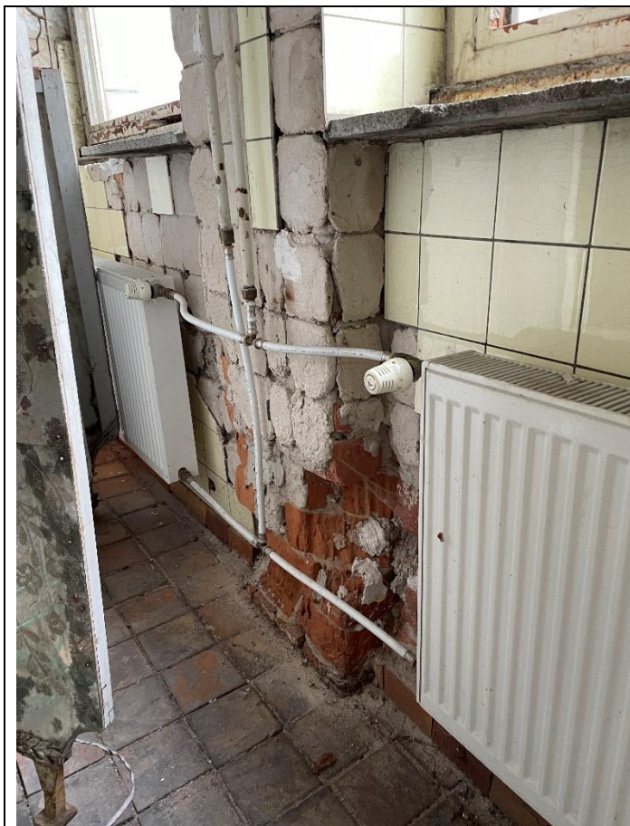
Výrazná erózia muriva v päte murovaného piliera
