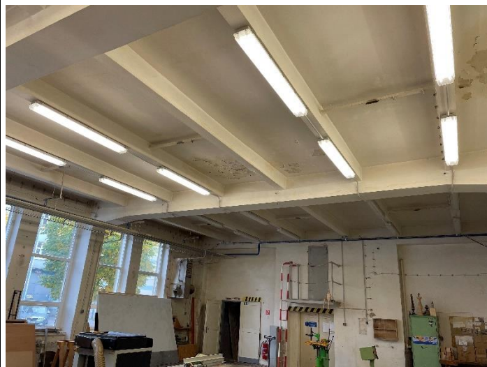
Pohľad na trámový strop nad stolárskou strojovňou – badať známky zatekania zrážkovej vody
