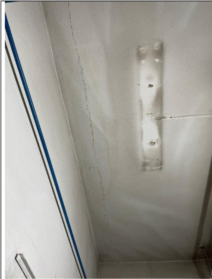
Trhlina v styku stropných panelov
