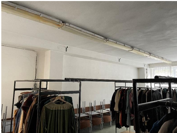
Vodorovné trhliny v nosnom murive
