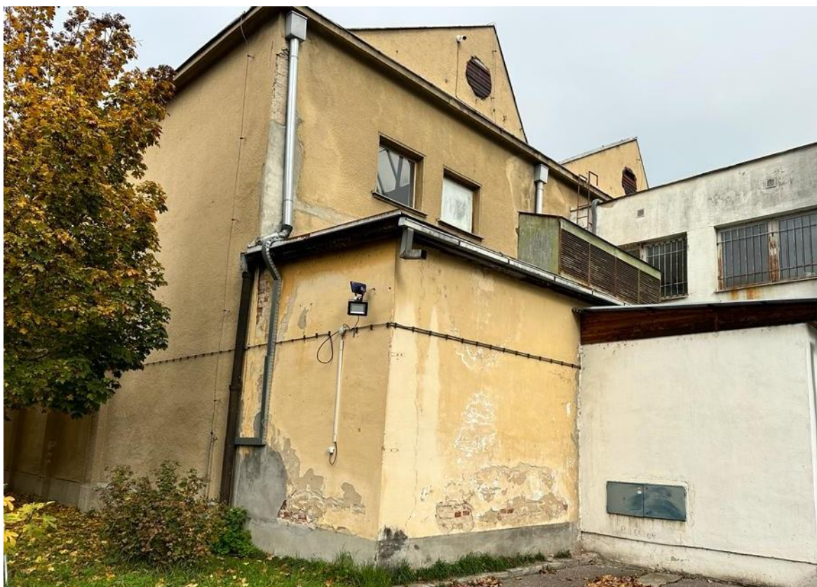
Obrázok 10: Pohľad na poškodenú časť fasády
