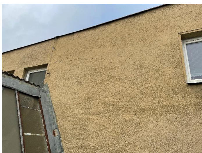
Trhlina v obvodovom murive zo strany exteriéru
