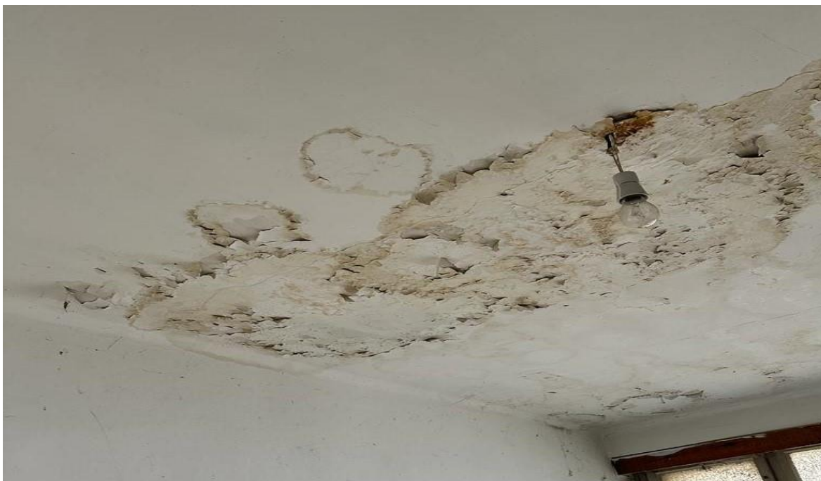
Obrázok 29: Byt správcu - porucha spôsobená zatekaním strechy
