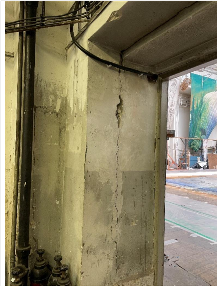
Trhlina v dilatácii, styku dvoch konštrukčných celkov
