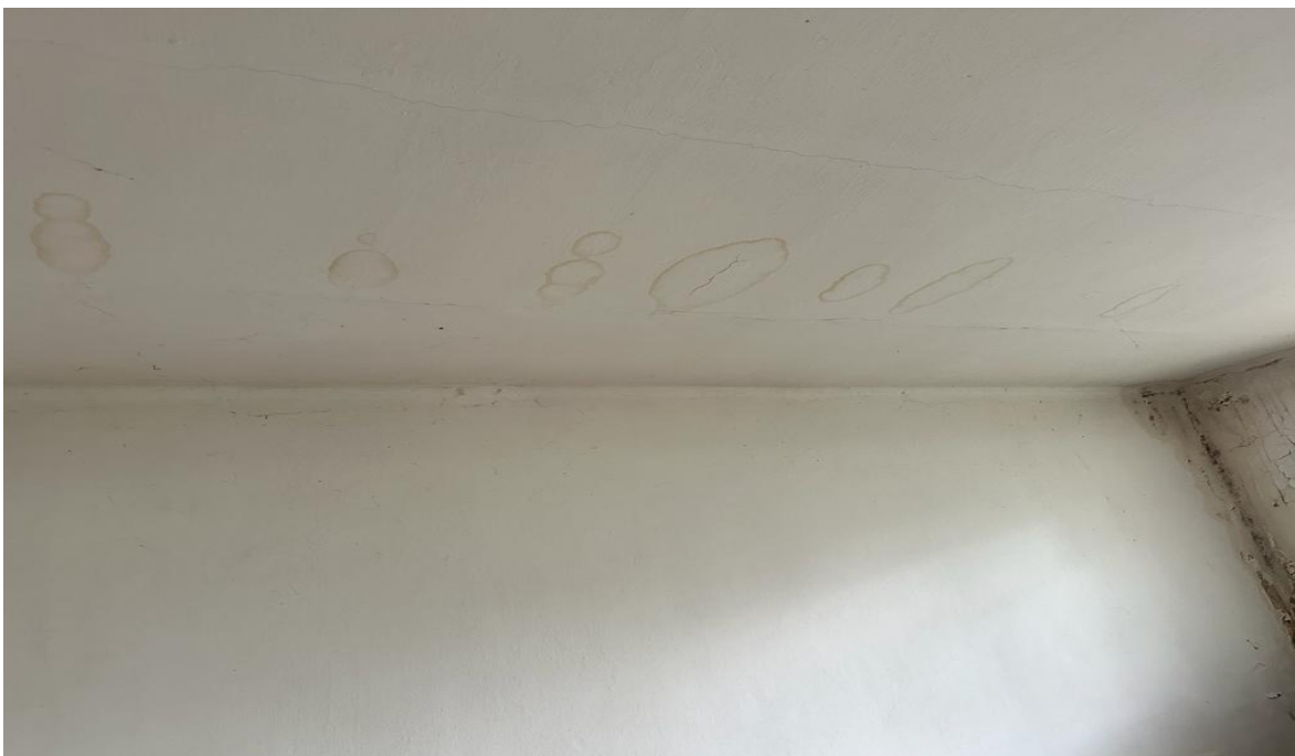
Obrázok 30: Byt správcu - porucha spôsobená zatekaním strechy
