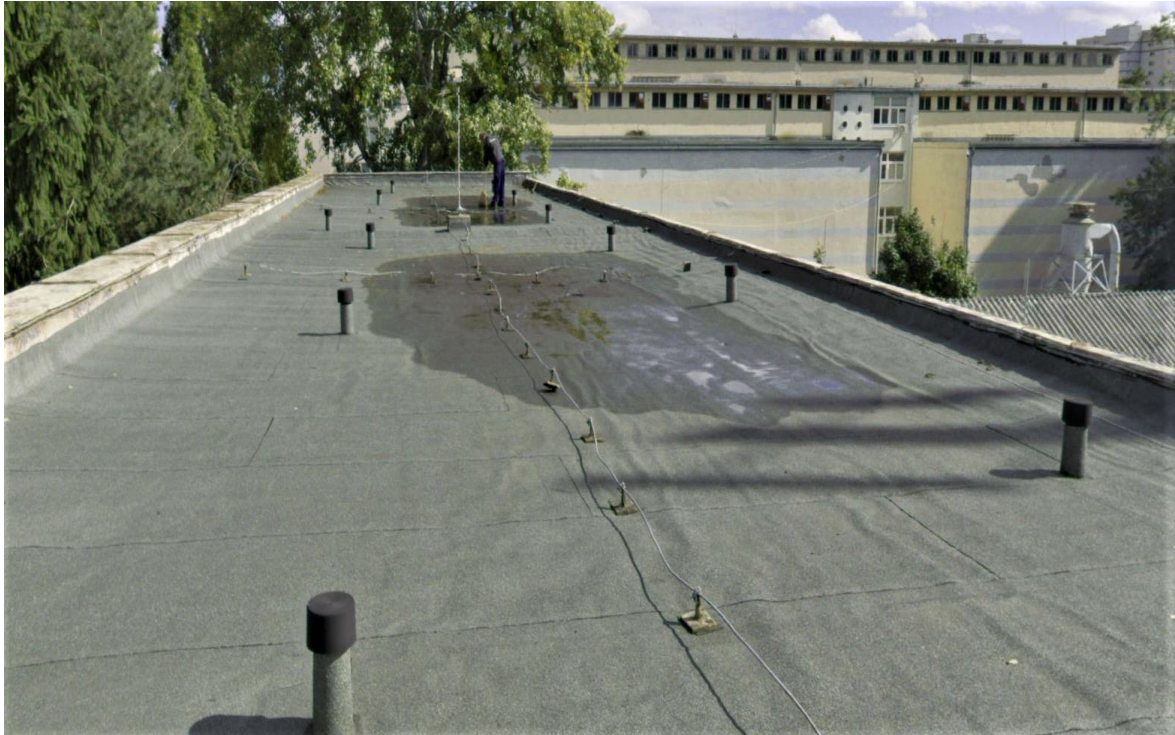
Obrázok 16: Pohľad na zlý nesprávne vypádovanú strechu plochej strechy
