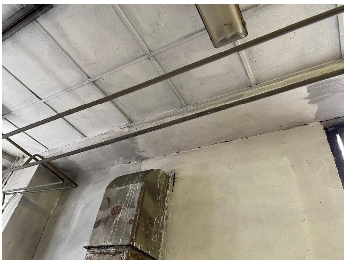
Trhlina v styku medzi nosným skeletom a obvodovým plášťom
