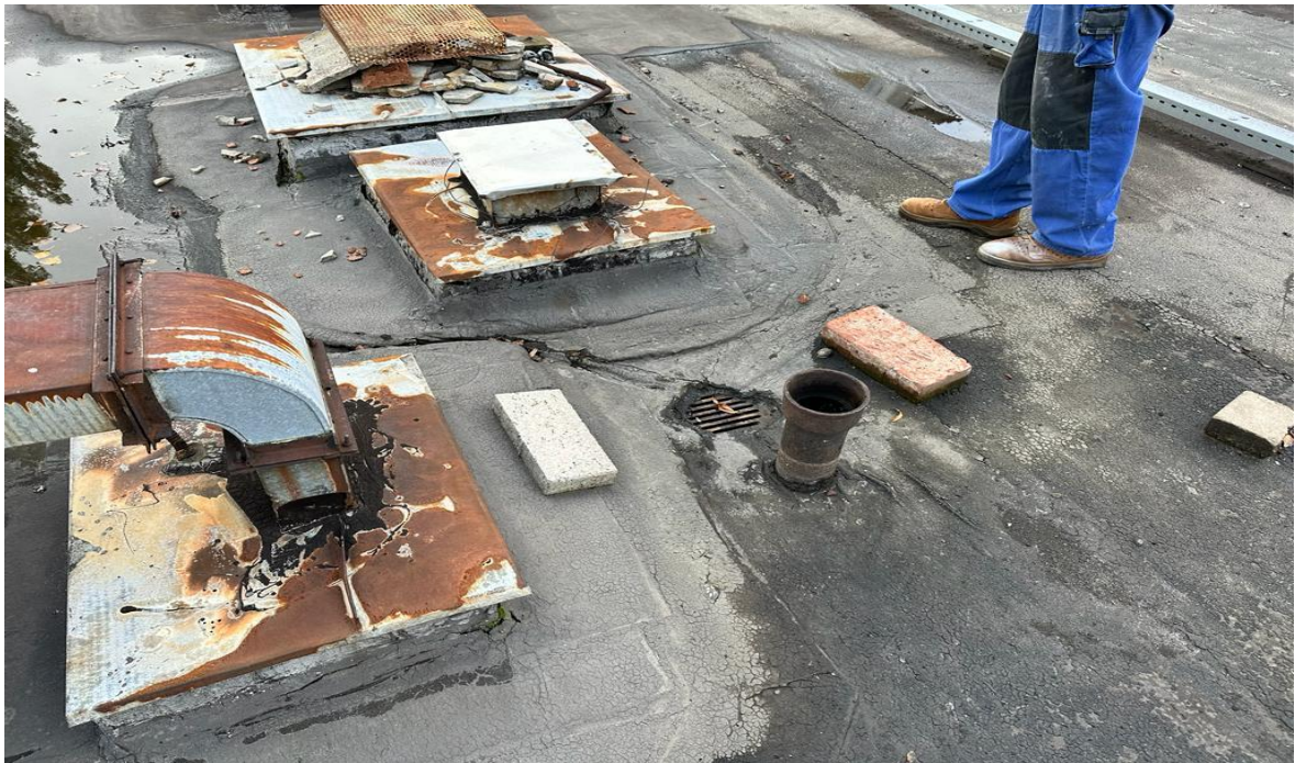
Obrázok 12: Pohľad na zdegradované časti strešnej konštrukcie
