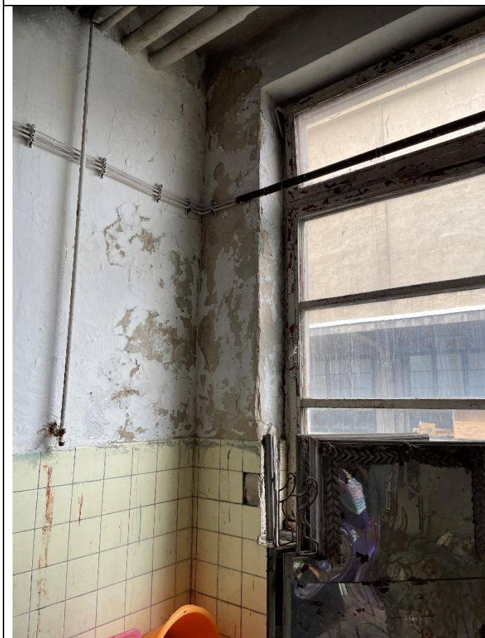
Zatečenie v rohu budovy z dôvodu poškodenej strešnej hydroizolácie
