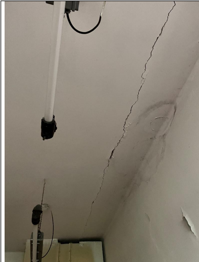
Trhlina v stropnej konštrukcii
