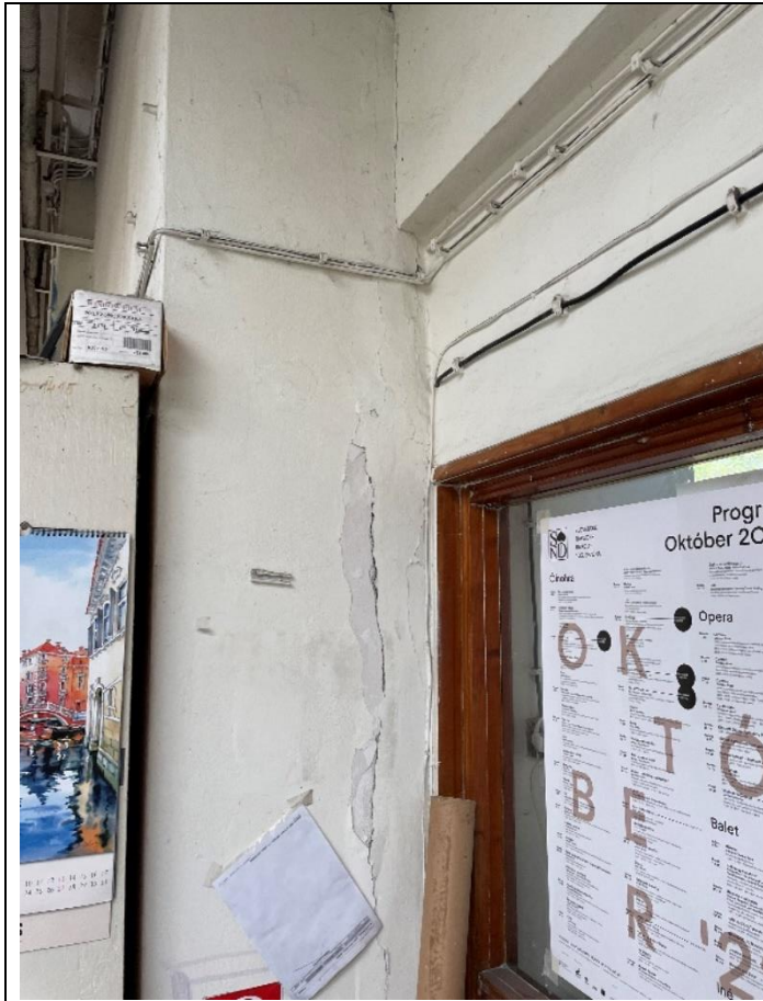
Trhlina v dilatácii, styku dvoch konštrukčných celkov
