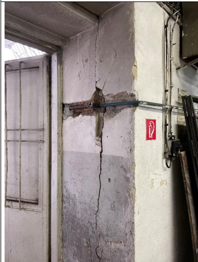
Trhlina v dilatácii, styku dvoch konštrukčných celkov
