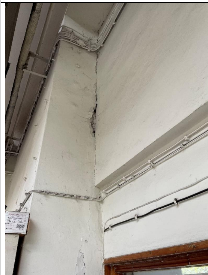
Trhlina v dilatácii, styku dvoch konštrukčných celkov
