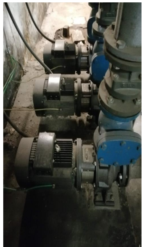
Obr. Obehové čerpadlá vykurovacej vody
