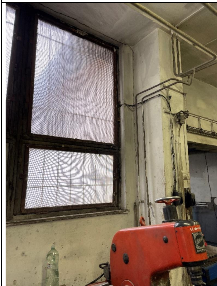
Trhlina v styku medzi nosným skeletom a obvodovým plášťom
