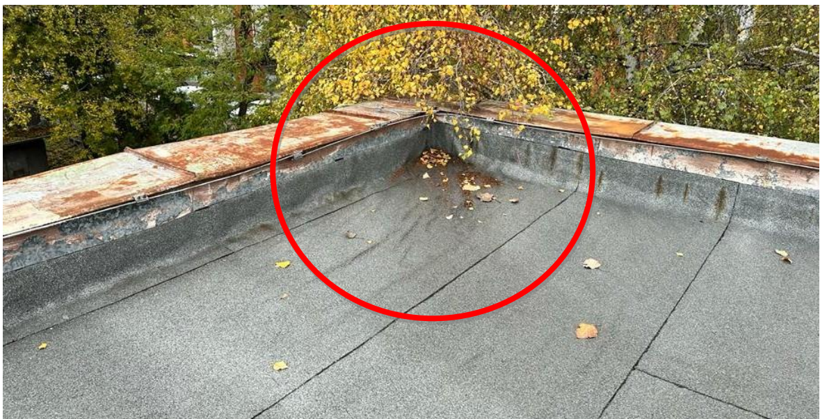
Obrázok 13: Vyznačené miesto poškodenej vrstvy strechy - exteriér
