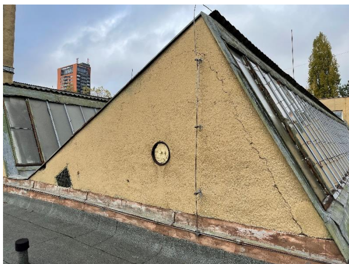
Trhlina na styku ocelevej konštrukcie a výplňového muriva v štíte strechy nad veľkou stolárskou dielňou
