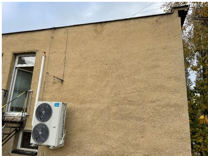
Trhlina v obvodovom murive zo strany exteriéru
