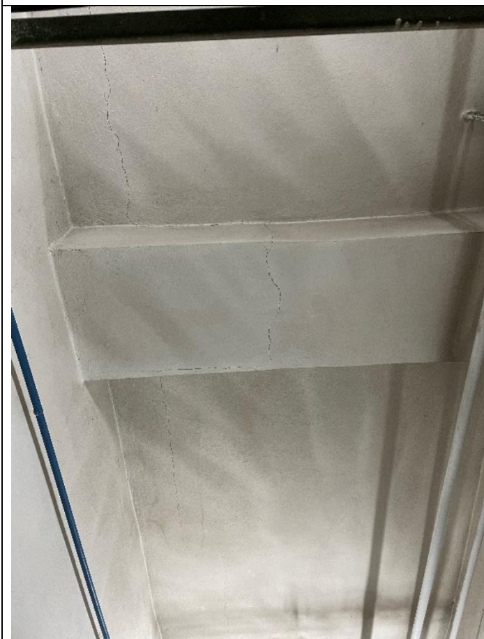
Trhlina v styku stropného nosníka a stropných panelov
