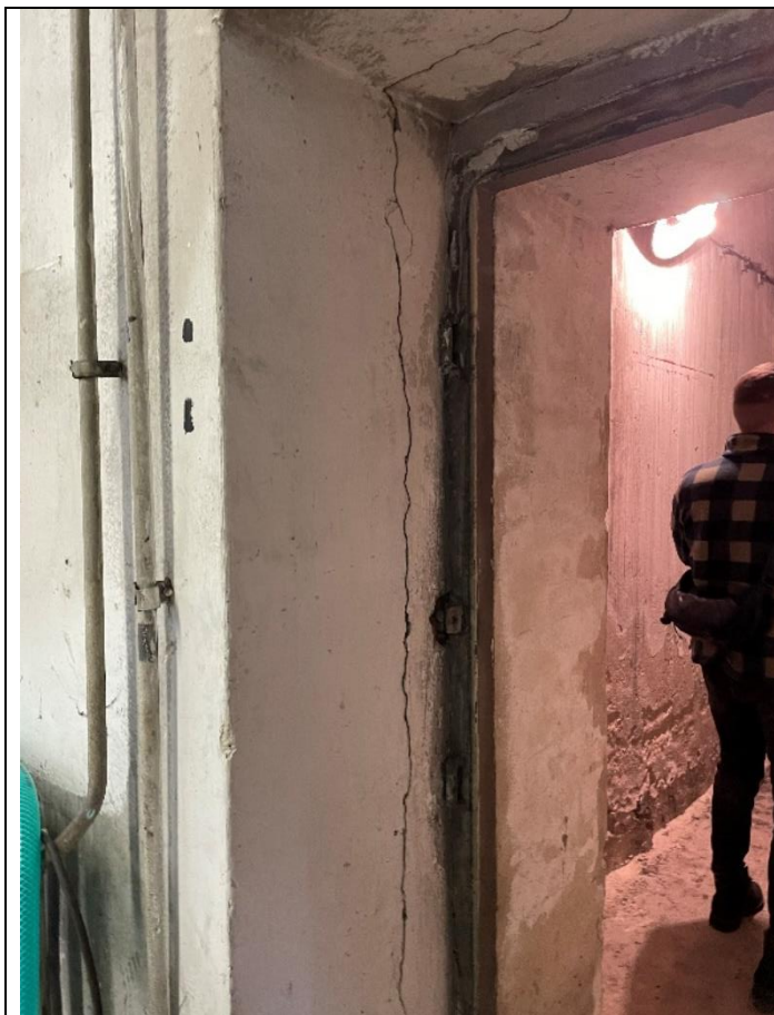
Trhlina v dilatácii, styku dvoch konštrukčných celkov
