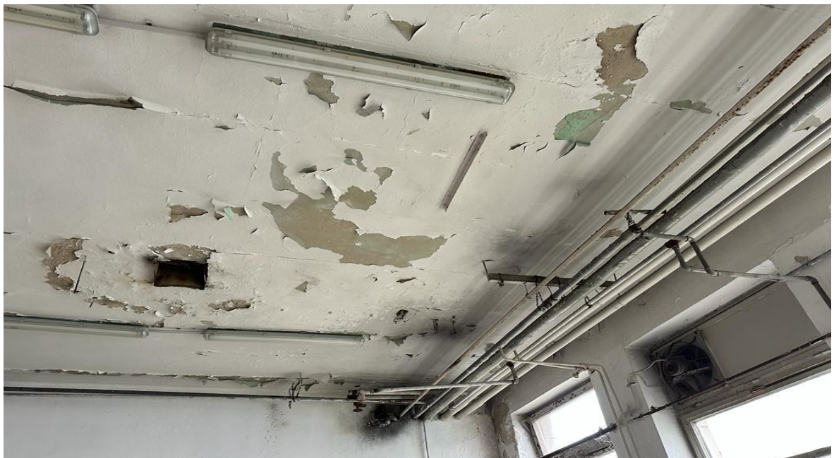
Obrázok 32: Práčovňa/sušiareň – porucha spôsobená zatekaním strechy
