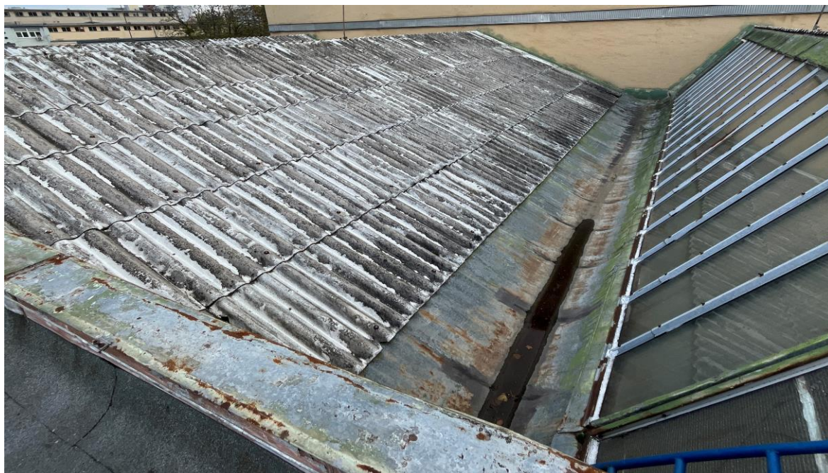
Obrázok 9: Pohľad na kaluž stojatej vody v úžľabí a zdegradované oplechovanie
