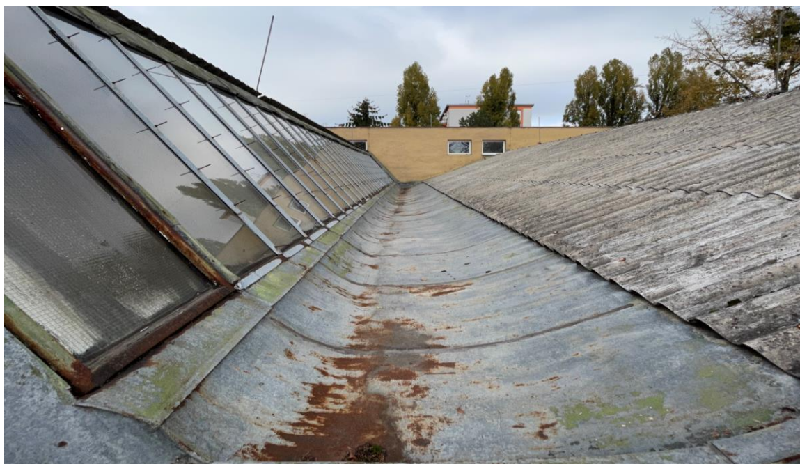
Obrázok 8: Pohľad na zdegradované okenné rámy a oplechovanie strechy
