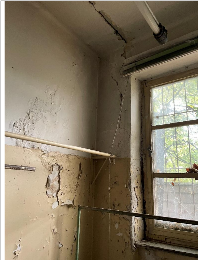
Trhlina v obvodovej stene
