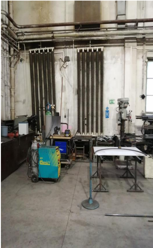
Obr. Vykurovacie registre v zámočnickej dielni
