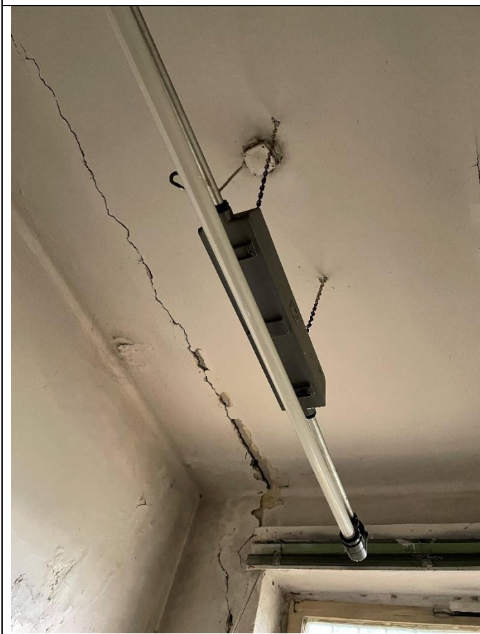
Trhlina v stropnej konštrukcii
