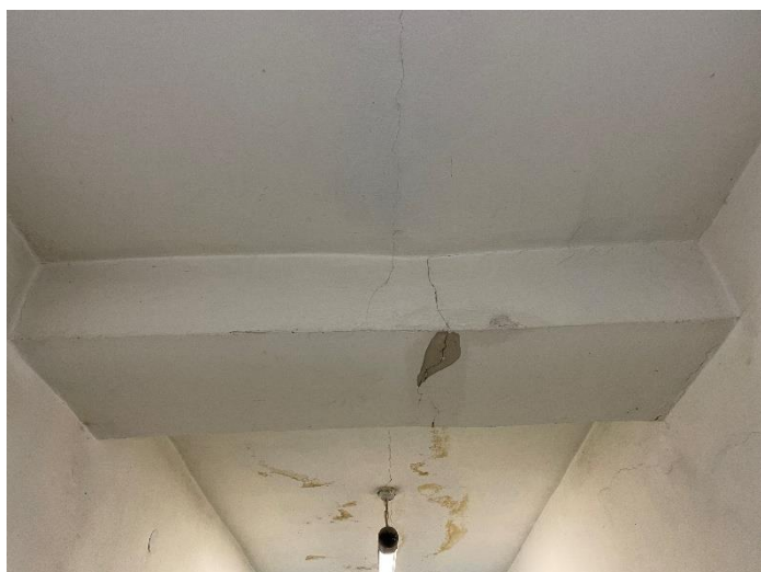
Trhlina v styku stropného nosníka a stropných panelov
