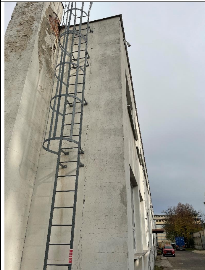
Opadaná omietka na komíne vplyvom pôsobenia zrážkovej vody
