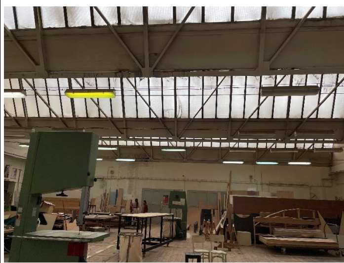
Pohľad na strešnú konštrukciu nad veľkou stolárskou dielňou – badať známky lokálnej jemnej korózie
