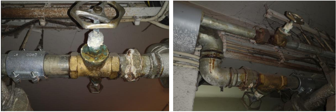
Obrázok č.1 – ležaté potrubia vodovodu bez izolácie s opravnou Gebo spojkou
